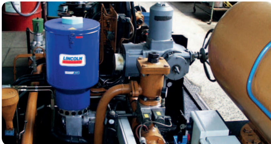
Für Wasserkraftwerke und Turbinen, die rund um die Uhr im Einsatz sind, ist eine zuverlässige Versorgung mit Schmierstoff erforderlich.
